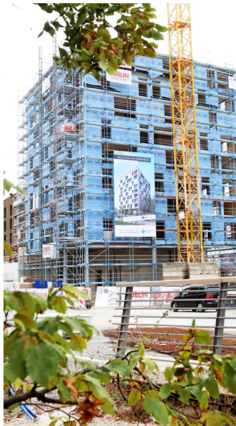
Auf den ersten Blick wird man nicht erkennen, dass das Skaio im Neckarbogen ein Holzhochhaus ist. Die Fassade ist mit Aluminiumplatten verkleidet. Fotos: Ralf Seidel
